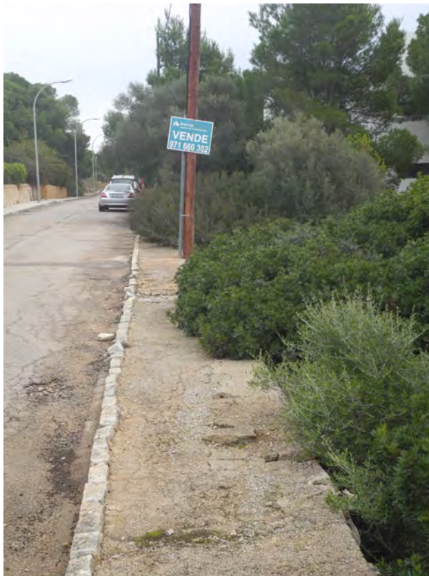
Imatges 5 i 6. Els vials de les urbanitzacions estan oberts, si bé en alguns casos el paviment es troba deteriorat o no hi ha voravies.
